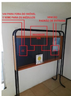
Local de instalação do inversor
