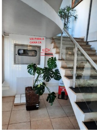
Saída dos cabos CA do padrão de entrada
